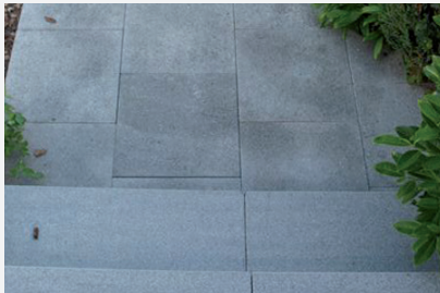
Feuchte im Untergrund
