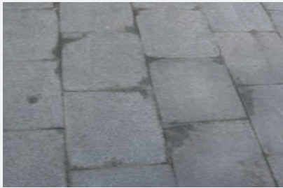
Feuchte im Untergrund
