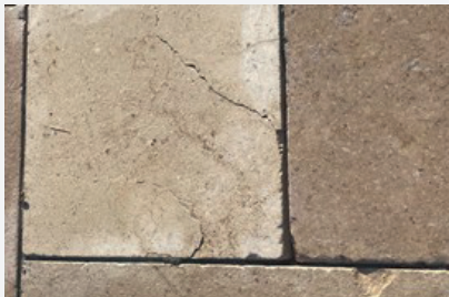
Schäden durch eingetragene Steinchen
