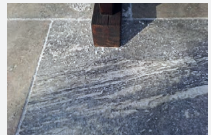
Fuge zu dicht – Kalk zieht hoch
