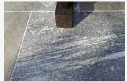
Fuge zu dicht – Kalk zieht hoch
