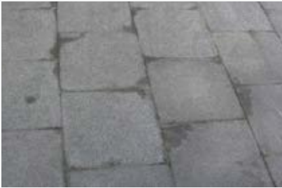
Feuchte im Untergrund
