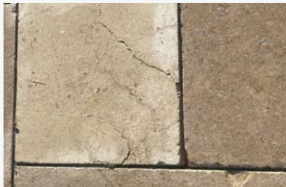
Schäden durch eingetragene Steinchen
