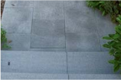
Feuchte im Untergrund
