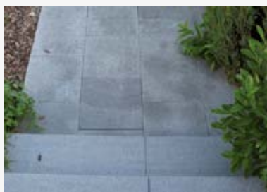
Feuchte im Unterbau
